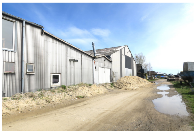
Den skæve værkstedsbygning midt i miljøet harmonerer med den øvrige bebyggelse og bør bevares.
