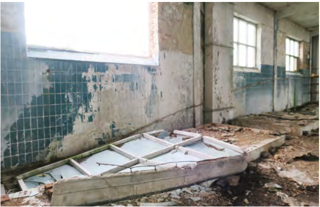
Indvendigt i en af papirmaskinehallerne, hvor et af de store jernvinduer er kollapsede. Flere af bygningerne trænger til en istandsættelse
