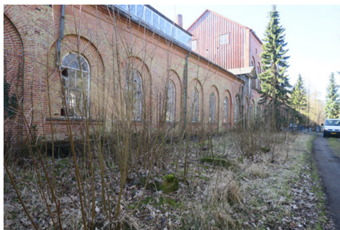
Saftstationens facade mod nord trænger til istandsættelse
